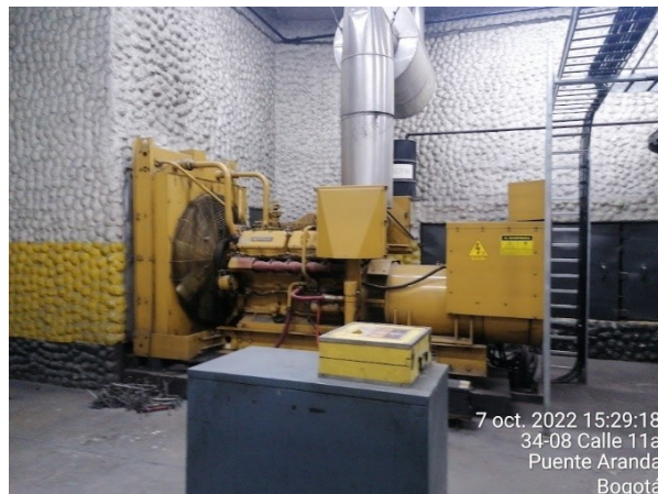
FOTOGRAFÍA No. 8. Planta eléctrica 1
