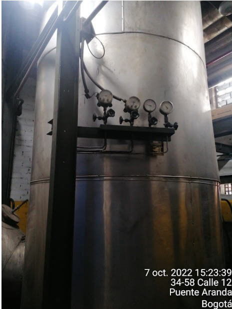
FOTOGRAFÍA No. 3. Caldera Wiesloch de 2.000.000 Kcal/h.
