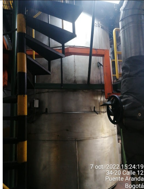
FOTOGRAFÍA No. 4. Caldera Konnus II de 2.500.000 Kcal/h
