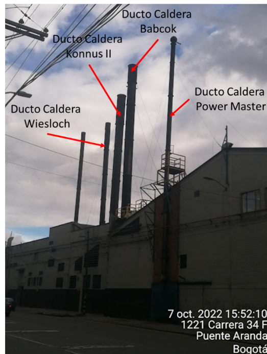
FOTOGRAFÍA No. 12. Ductos Calderas
