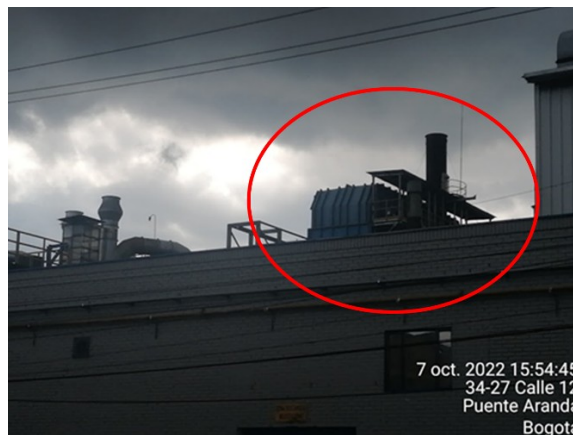
FOTOGRAFÍA No. 10. Regenerador Térmico RT1 y ducto
