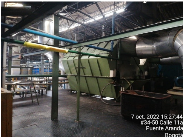
FOTOGRAFÍA No. 7. Equipos de descontaminación Ramas 1 y 3.
