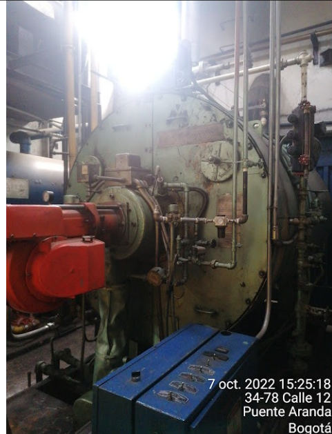
FOTOGRAFÍA No. 6. Caldera Power Master de 100 BHP.
