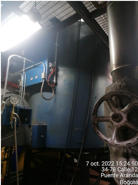
FOTOGRAFÍA No. 5. Caldera Babcock de 290,98 Kw.
