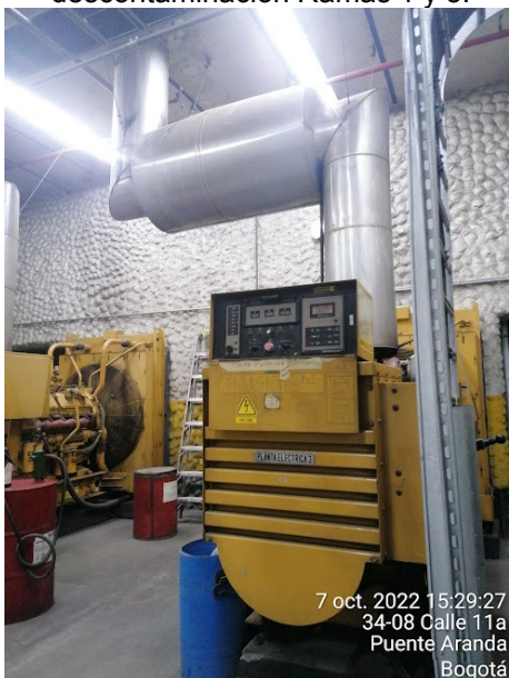
FOTOGRAFÍA No. 9. Planta eléctrica 3
